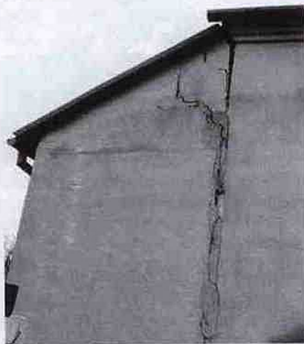
Domu p. Heleny Kornaga (Józefowska 2) z pęknięciami, że można włożyć w nie rękę – stoi bliżej drogi niż Kościół
